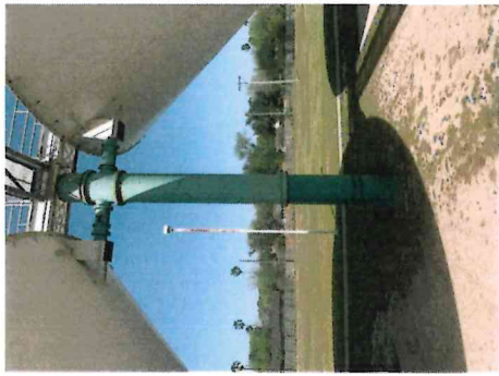
4 CLARIFIER EFFLUENT MAIN
